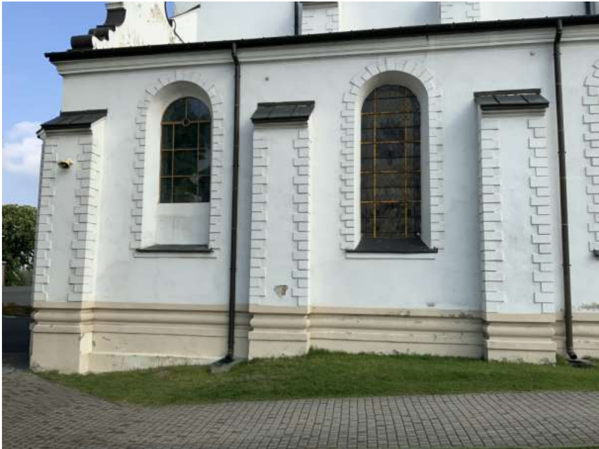
Fot. 4: Fragment elewacji południowej - Zbliżenie na część elewacji południowej, ilustrujące stan tynków.
