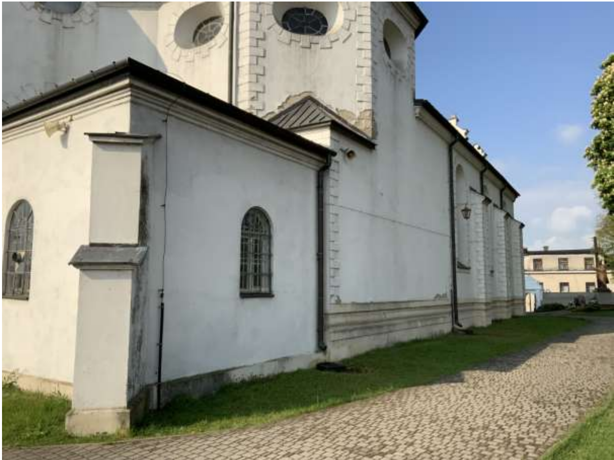
Fot. 9: Elewacja północna - Widok na elewację północną z zaznaczonym zagrożeniem mikrobiologicznym, wpływającym na degradację materiałów budowlanych.
