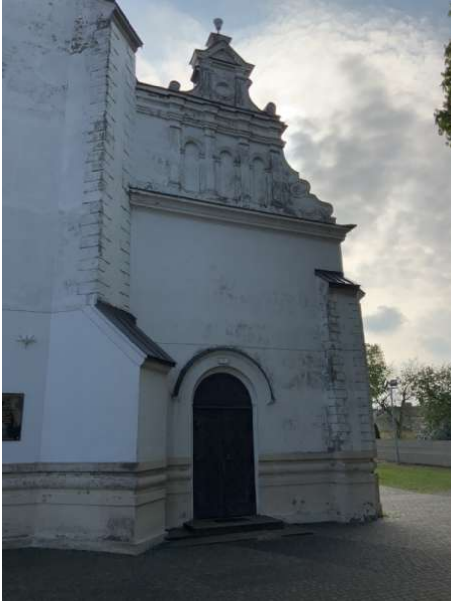
Fot. 2: Elewacja zachodnia, nawa boczna prawa - Widok na prawa nawę boczną elewacji zachodniej, ukazujący elementy architektoniczne i ich stan zachowania.
