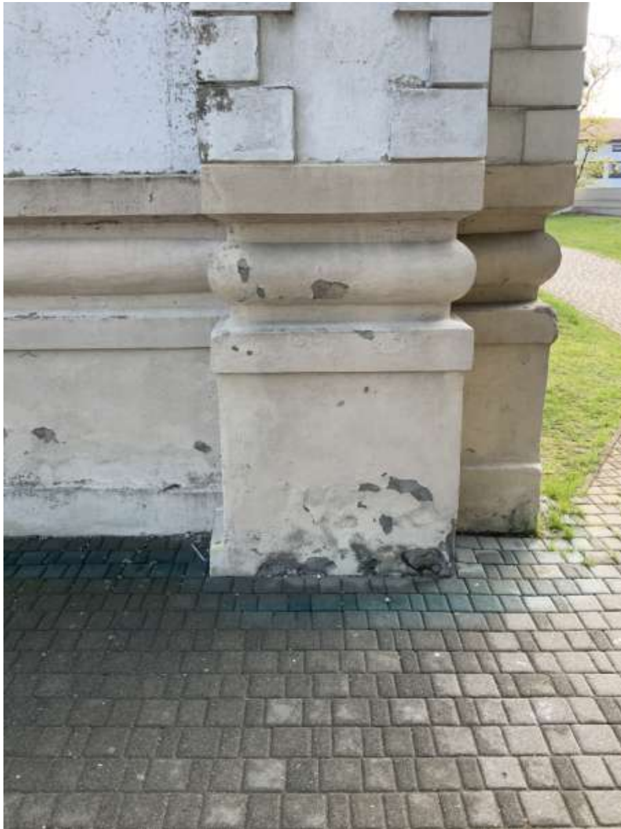
Fot. 5: Fragment elewacji zachodniej - Analiza wpływu kostki brukowej na stan zachowania tynków elewacji zachodniej.
