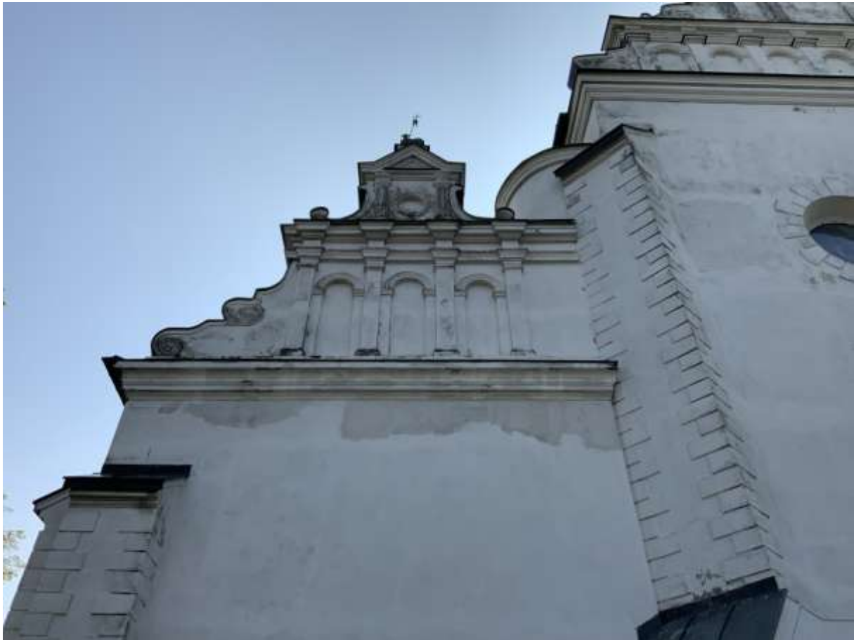
Fot. 10: Elewacja południowa - Zniszczeń w wyższych partiach elewacji południowej, wskazująca na potrzebę szczegółowej analizy i interwencji konserwatorskich.
