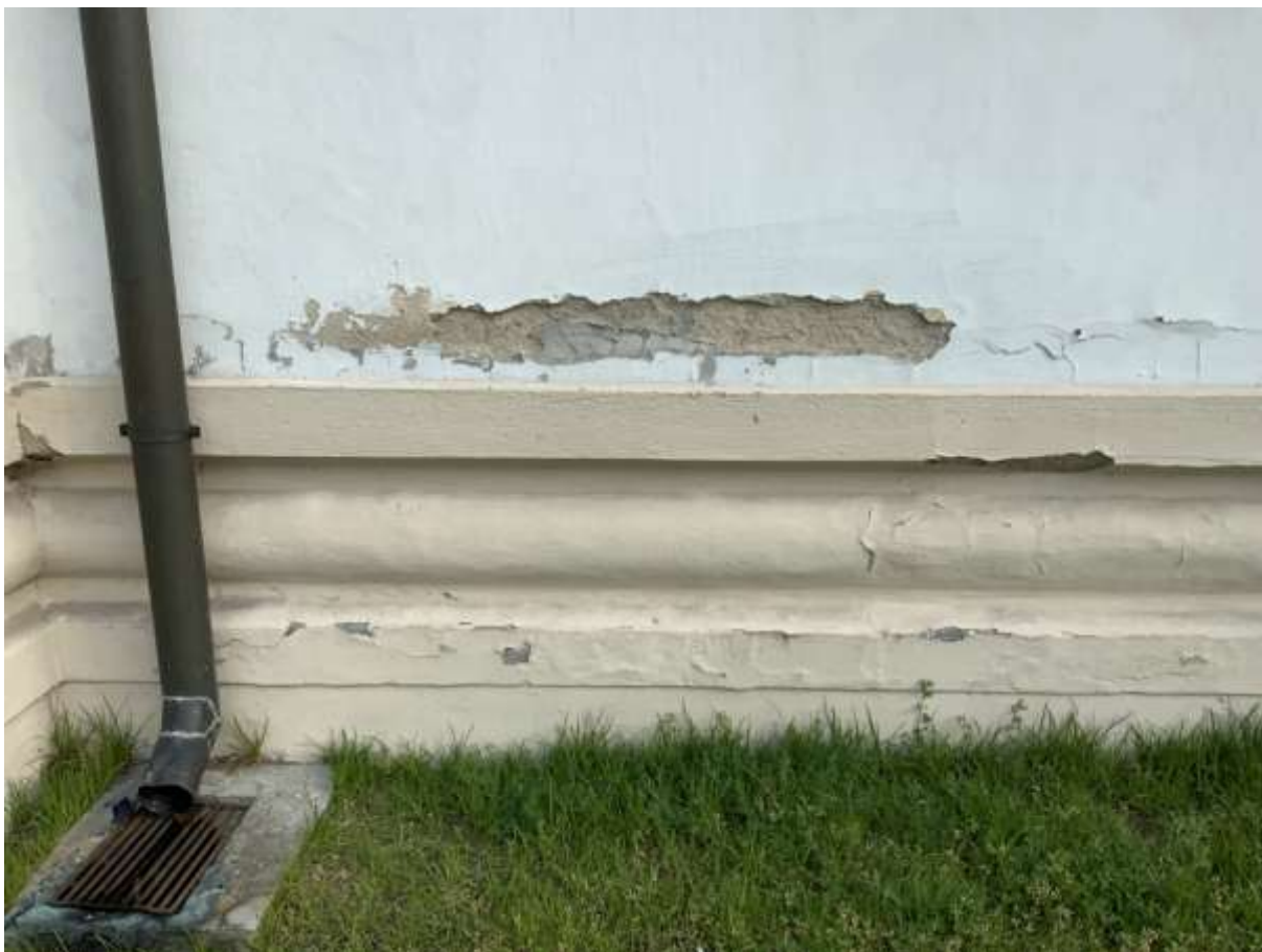
Fot. 6: Fragment elewacji południowej - Dokumentacja wpływu warstwy cementowej na cokół, z uwzględnieniem skutków nagromadzenia wilgoci i procesów odparowania w górnych partiach cokołu.
