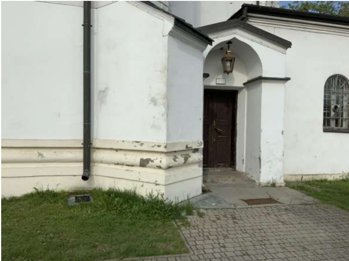
Fot. 9: Elewacja północna - Widok na elewację północną z zaznaczonym zagrożeniem mikrobiologicznym, wpływającym na degradację materiałów budowlanych.
